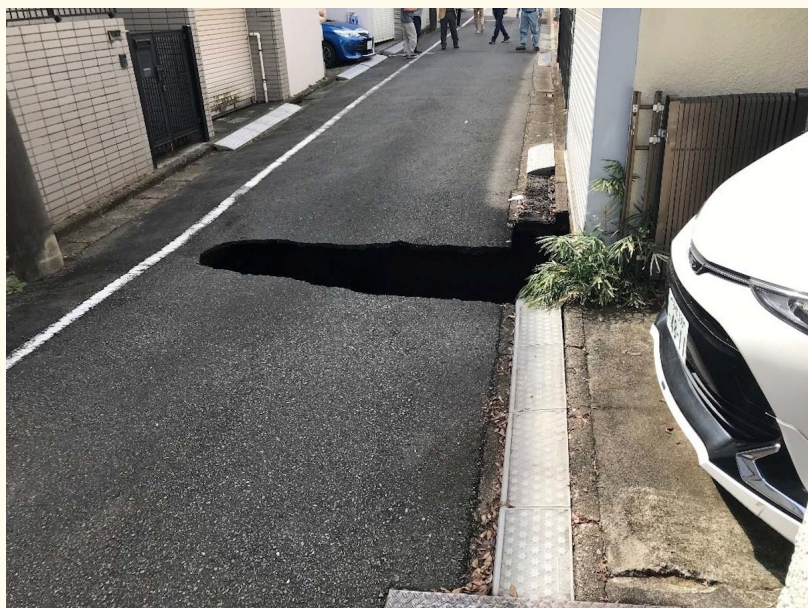
陥没事故現場 (出典 : NEXCO東日本)
